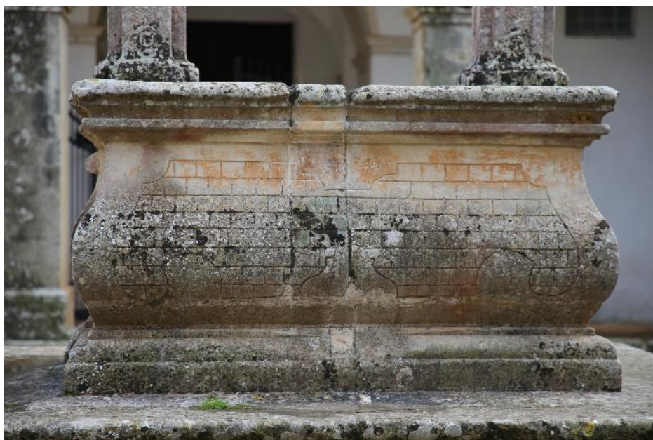
Sternatia, Chiostro del Convento dei Domenicani, Viste del chiostro, particolari della cisterna centrale, Ph Paola Durante, 2026
